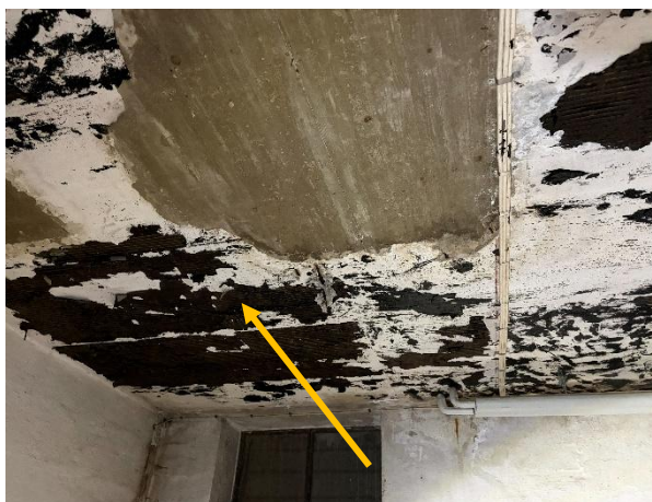
Foto 19. Svart strykning och papp i tak på källarplan (se orange markering) innehåller förhöjd halt PAH-M (23,1 mg/kg) och PCB-7 (1,99 mg/kg), verifierat via prov 260428:31.
