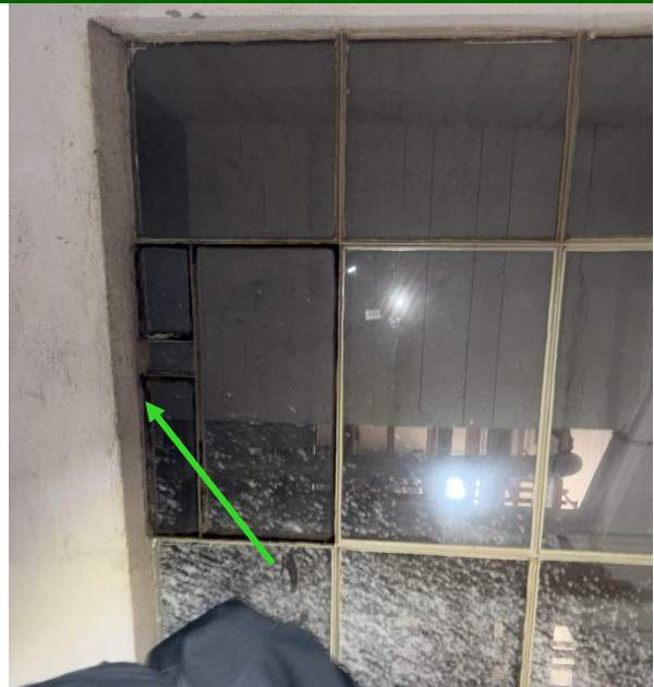
Foto 26. Kladdig invändig fog förekommer vid fönster i rum 5 på plan 3, se grön pil. Fog innehåller ej bly överskridande GvFA. Innehåller ej asbest, PCB eller PCA överskridande laboratoriets rapporteringsgräns.
