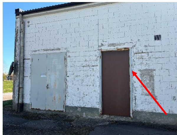
Foto 12. Fog runt port på fasad mot väster (se röd pil) innehåller PCA (klorparaffiner), verifierat via prov 260428:22. Fog bedöms innehålla PCA överskridande GvFA.
