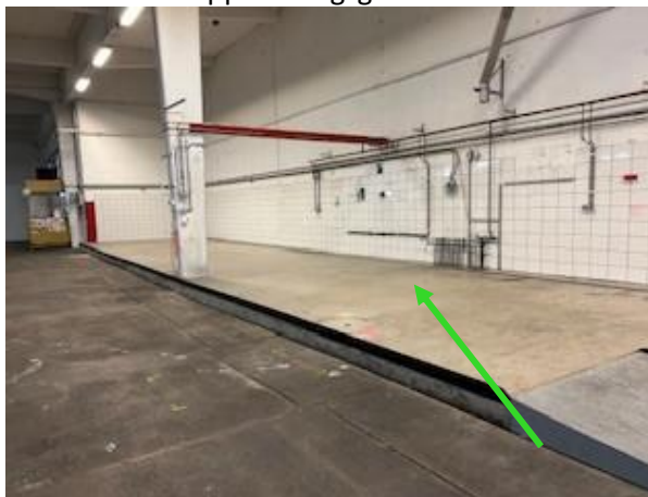
Foto 27. Massagolv i del av rum 1 på bottenplan (se grön pil) innehåller ej asbest eller PCB överskridande laboratoriets rapporteringsgräns, verifierat via prov 260416:1E.
