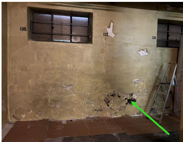
Foto 31. Svart strykning förekommer på väggen bakom väggfärg i rum 11 på bottenplan, se grön pil.
