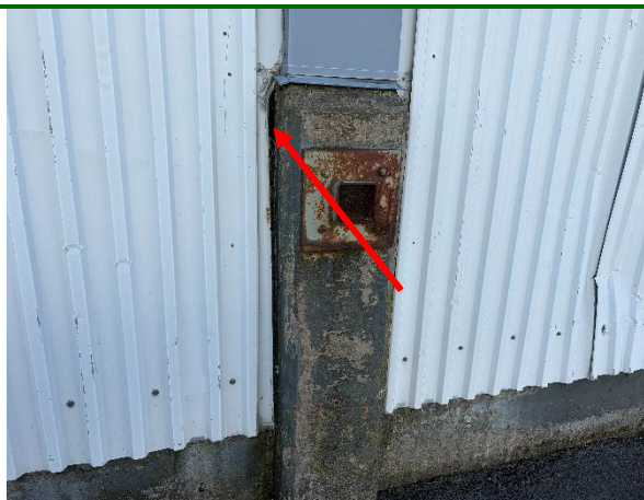
Foto 14. Grå utvändig fogmassa vid pelare på fasad mot väst (se röd pil) innehåller PCB (144 000 mg/kg) och bly (29 200 mg/kg) överskridande GvFA, verifierat via prov 260428:20.
