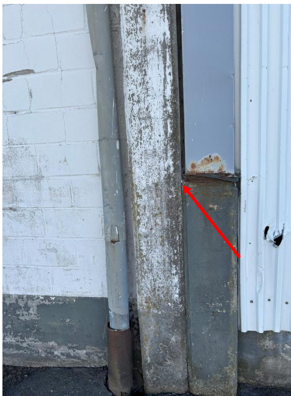
Foto 15. Utvändig fog i skarv mellan ursprunglig byggnad och tillbyggnad på fasad mot väster (se röd pil) innehåller PCB (466 mg/kg) överskridande GvFA, verifierat via prov 260428:21.
