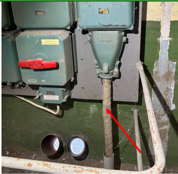
Foto 9. Oljehaltiga kablar (se röd pil) bedöms utifrån årtal och tidigare erfarenhet innehålla PCB, PAH och oljekolväten överskridande GvFA till dess att motsatsen är bevisad.
