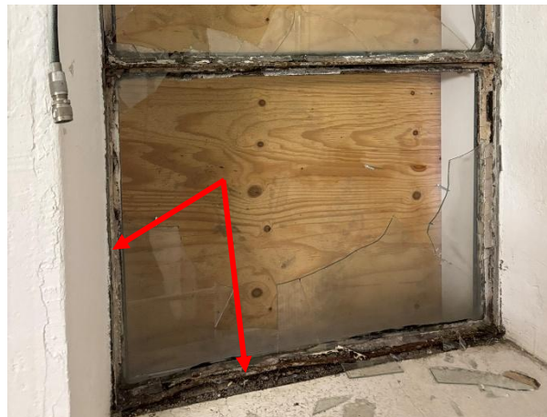
Foto 8. Ursprungliga fönster förekommer generellt. Vitt fönsterkitt innehåller bly (se röda pilar) (3550 mg/kg), verifierat via prov 260428:16.
