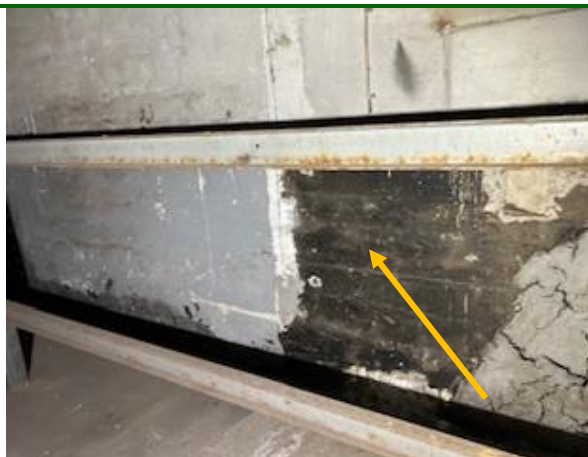
Foto 18. Svart strykning på innervägg i del av rum 3 på bottenplan (se orange markering) innehåller förhöjd halt PAH-M (31,8 mg/kg), verifierat via prov 260416:10.
