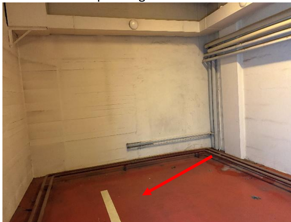
Foto 7. Röd golvmatta (se röd pil) innehåller asbest och PCA (klorparaffiner) överskridande GvFA, verifierat via prov 260428:23. Innehåller ej PCB överskridande laboratoriets rapporteringsgräns. Golvmatta behöver hanteras enligt gällande lagstiftning och branschregler vid framtida åtgärder.
