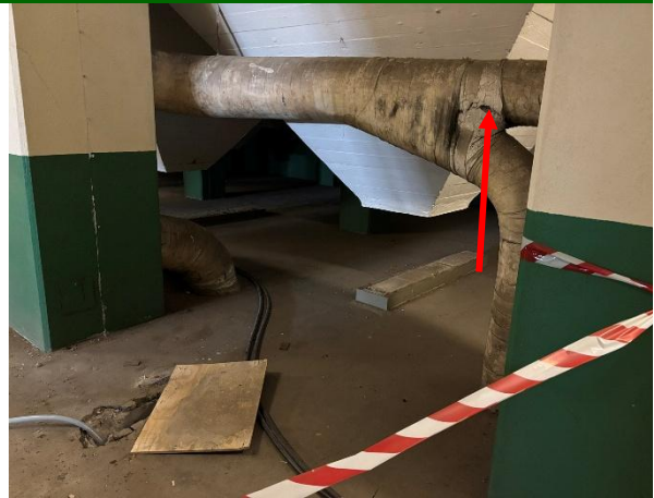
Foto 2. Foto taget i rum 4 på plan 2. Trasiga varmvattenrör som innehåller asbesthaltig gurmassa (se röd pil) rekommenderas att åtgärdas omgående för att undvika spridning av asbestfibrer.
