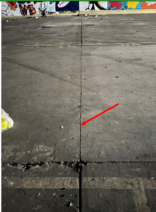
Foto 5. Svart fog/tätning förekommer i springor i golv i rum 6 och 8 på bottenplan, se röd pil. Fog/tätningen innehåller asbest, verifierat via prov 260416:2. Innehåller förhöjd halt PAH-M (11,6 mg/kg) och PAH-H (5,75 mg/kg).
