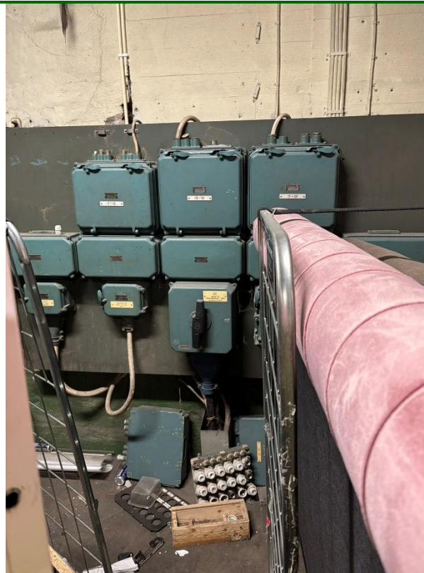
Foto 6. Äldre elskåp och installationer förekommer i stor omfattning i byggnaden. Installationerna bedöms utifrån årtal och erfarenhet innehålla komponenter av asbest, PCB och Hg.
