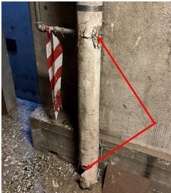
Foto 3. Exempelbild på trasigt varmvattenrör med risk för spridning av asbestfibrer (se röda pilar).
