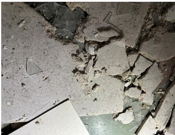
Foto 35. Nedrivna undertaksplattor i rum 7 på plan 3 innehåller ej asbest, verifierat via prov 260428:25.
