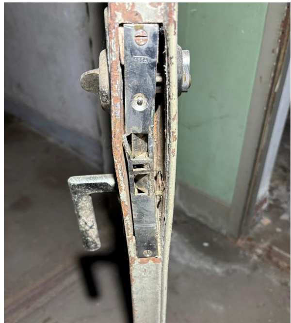
Foto 4. Uppbräckt låskista till branddörr på källarplan innehåller asbesthaltig isolering och rekommenderas att åtgärdas omgående för att undvika spridning av asbestfibrer.
