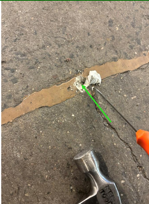
Foto 21. Brun tätning i golv i rum 1 på bottenplan (se grön pil) innehåller lågt halt bly (7,1 mg/kg). Innehåller ej asbest, PCA eller PCB överskridande laboratoriets rapporteringsgräns, verifierat via prov 260416:13
