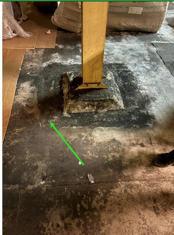
Foto 30. Svart skikt på golvet förekommer vid pelare i rum 11 på bottenplan, se grön pil. Svart skikt innehåller ej asbest eller PCA. Innehåller PCB (0,309 mg/kg), PAH-M (9,08 mg/kg) och PAH-H (15,4 mg/kg), verifierat via prov 260416:6. Innehåll av PAH och PCB bedöms, med hänvisning till Naturvårdsverkets beräkningsverktyg, inte ha en negativ påverkan på inomhusmiljön.
