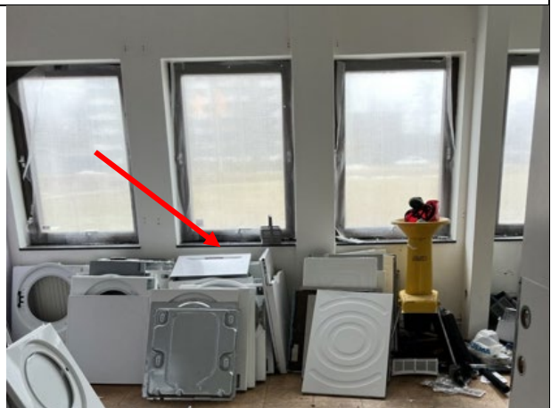
Foto.77;Svarta.fönsterbrädor.(röd.pil).förekommer. genomgående.i.tillbyggnaden.vid.träffönster;Fönsterbräda. bedöms.innehålla.eternit.(asbest).och.ska.vid.rivning.eller. ombyggnation.hanteras.som.asbesthaltigt.material;En. fönsterbräda.noterades.vara.skadad?vilken.bör.åtgärdas. omgående;
