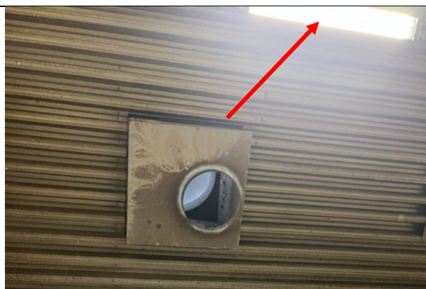
Foto.12; Äldre armatur innehåller PCB-kondensatorer och lysrör med kvicksilver (röd.pil); Äldre pluggad ventilationskanal ses också i bild;
