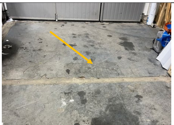
Foto.11; Rester av linoleummatta (orange.pil) bedöms innehålla ex. bly och bör provas i samband med eventuell rivning eller ombyggnation;
