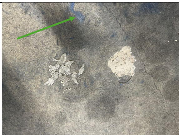
Foto.9; Blåmålat massagolv (grön.pil) innehåller ej asbest eller metaller och PCB i halter som överskrider gränsvärdet för farligt avfall eller som medför saneringsplikt? verifierat via prov. 8268809;
