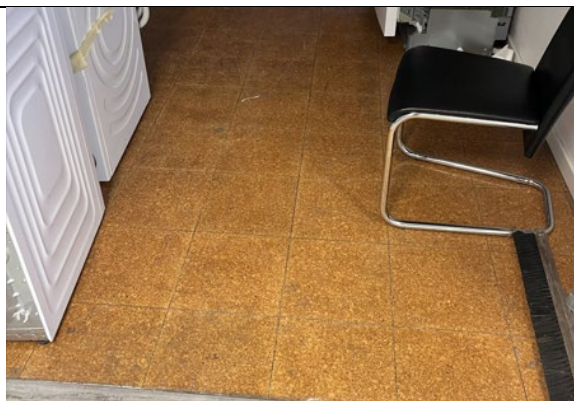
Foto.78; Äldre.korkmatta.kan.ex; innehålla.asbest.och.klorparaffiner.och.bör.provtas.inför.rivning.eller.ombyggnation; Svart.strykning-lim.kan.förekomma.under.äldre.mattor-ytskikt;
