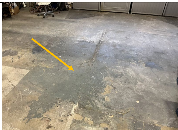
Foto.10; Betonggolv med färgspill (orange.pil) kan innehålla asbest? PCB och eller metaller. Färgspill bör provas i samband med framtida åtgärder;
