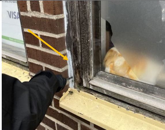
Foto.4.Fönsterfog.(orange.pil).runt.träffönster. innehåller.ej.asbest?verifierat.via.prov.8268811. Tidigare.genomförd.provtagning.i.samband.med.utförd. PCB_inventering.har.påvisat.förhöjda.halter. klorparaffiner.i.fogen?men.inte.PCB.överskridande.en. totalhalt.på.70ppm; Vid.rivning.ska.klorparaffiner. analyseras.för.att.fastställa.totalhalten;
