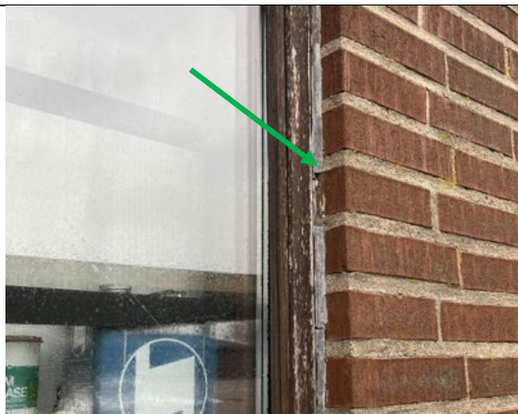
Foto.76;Fönsterfog.(grön.pil).runt.isolerglaskassett. innehåller.ej.asbest.eller.bly?klorparaffiner.och.PCB.i. halter.som.överskrider.gränsvärden.för.farligt.avfall? verifierat.via.prov.8268811.
