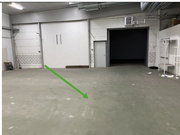
Foto.7; Grönmålat betongmassagolv i lagerlokal. (grön.pil) innehåller ej asbest eller metaller och PCB i halter överskridande gränsvärdet för farligt avfall? verifierat via prov. 8268807;
