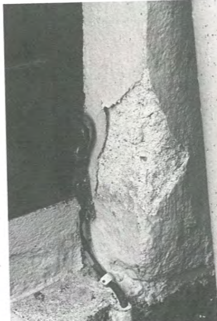
Moderna färger medför ofta svåra skador som är svåra att reparera. För tät färg innebär att putsen sprängs sönder.
